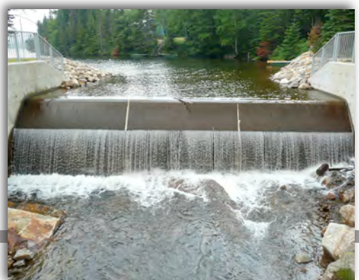
▼ Déversoir libre en béton
